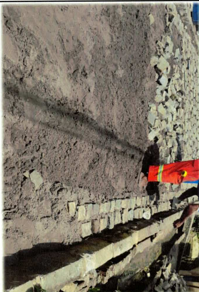
Foto n. 06 LINHA D'ÁGUA COM PARALELEPÍPEDOS GRANÍTICOS
