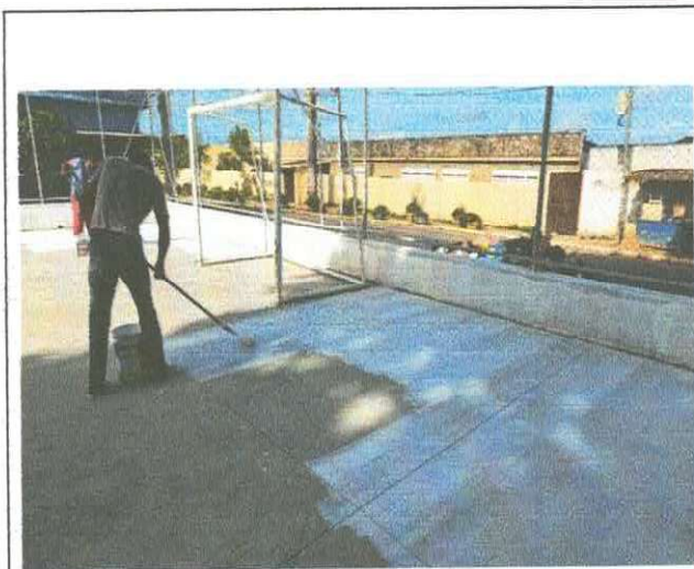
FOTO 09 - Juntas de dilatação da quadra
