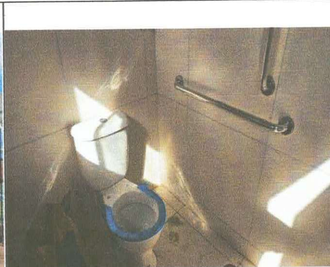
FOTO 18 - Vaso sanitário com caixa acoplada
